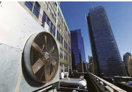
Lüfteranwendungen profitieren durch den Einsatz von Frequenzumrichtern
